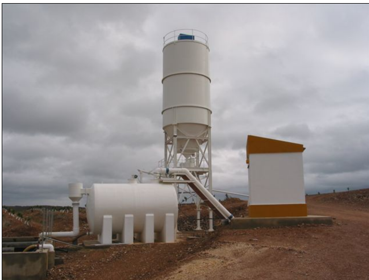
Foto 3: Vista Planta Tratamiento de Aguas
