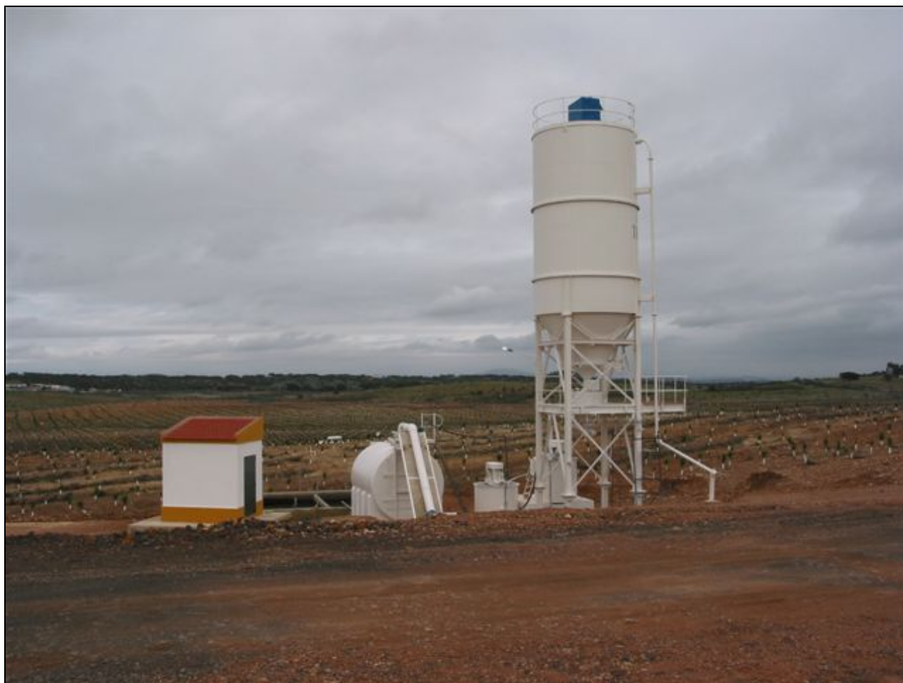
Foto 2: Vista Planta Tratamiento de Aguas
